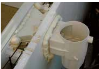
Collage des pièces à sceller à la mousse polyuréthane pendant l'élévation des parois.
